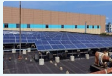
光伏发电系统
